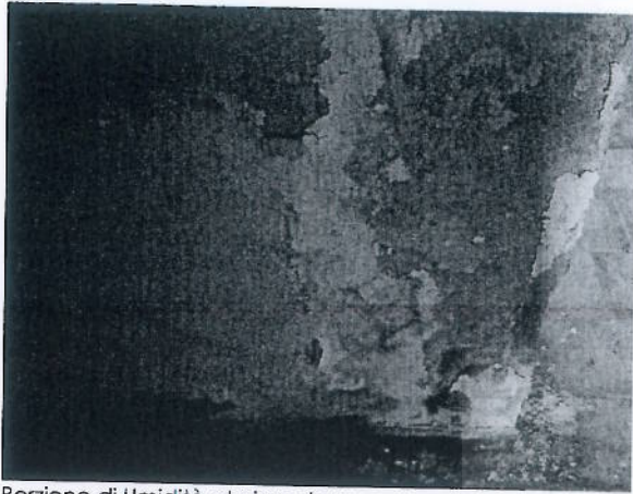
Porzione di Umidità al piano terra
